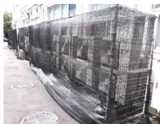
室外機は遮光ネットで冷房効率の向上を
