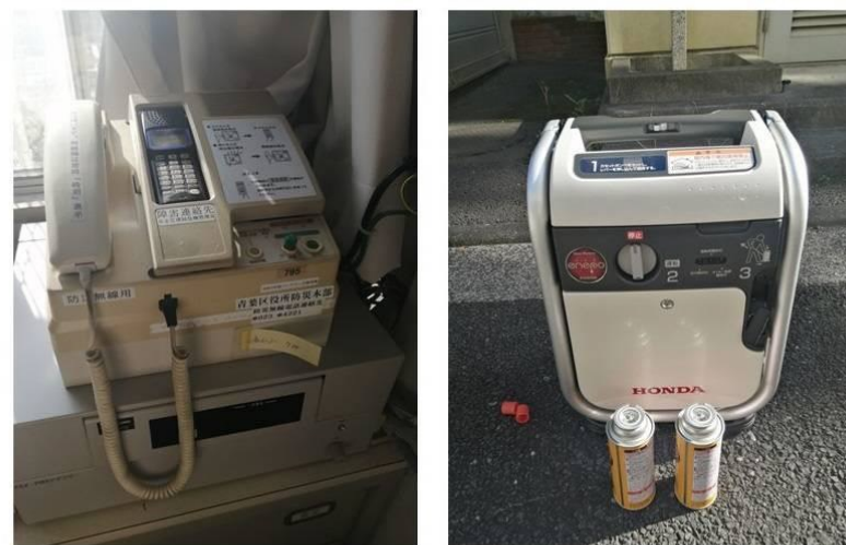
青葉区役所防災本部との 防災無線 カセットコンロ式発電機
