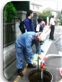
道路にある消火栓に水消火器を設置。
