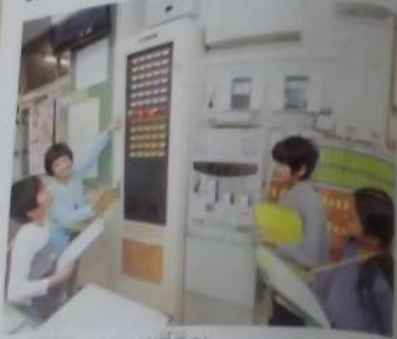
④ 自動火災報知うちせつび(受信器)
